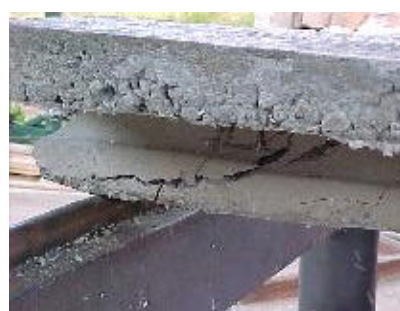
FOTOGRAFIA 2 - fissura na lateral da nervura após o colapso, concreto junto ao apoio se soltou. Inclinação das trincas bem menor que 450
