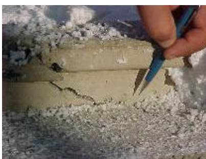
FOTOGRAFIA 1 –fissura na lateral da nervura após o colapso, carga a 35 cm do apoio, inclinação de trincas é menor que 450
